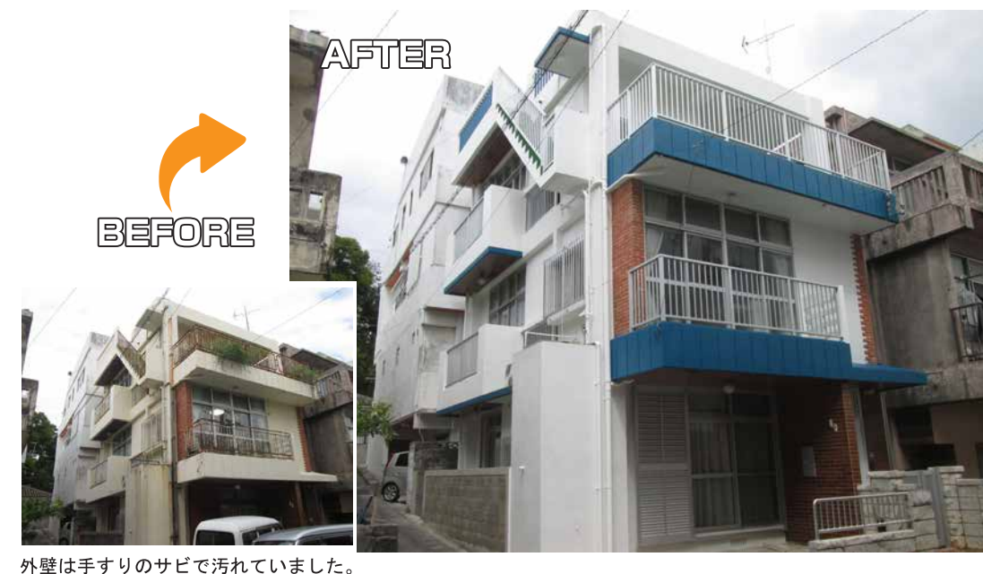
外壁は手すりのサビで汚れていました。
